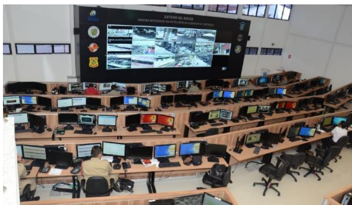
Figura 3: Centro Integrado de Inteligência Comando e Controle (CIICC).
