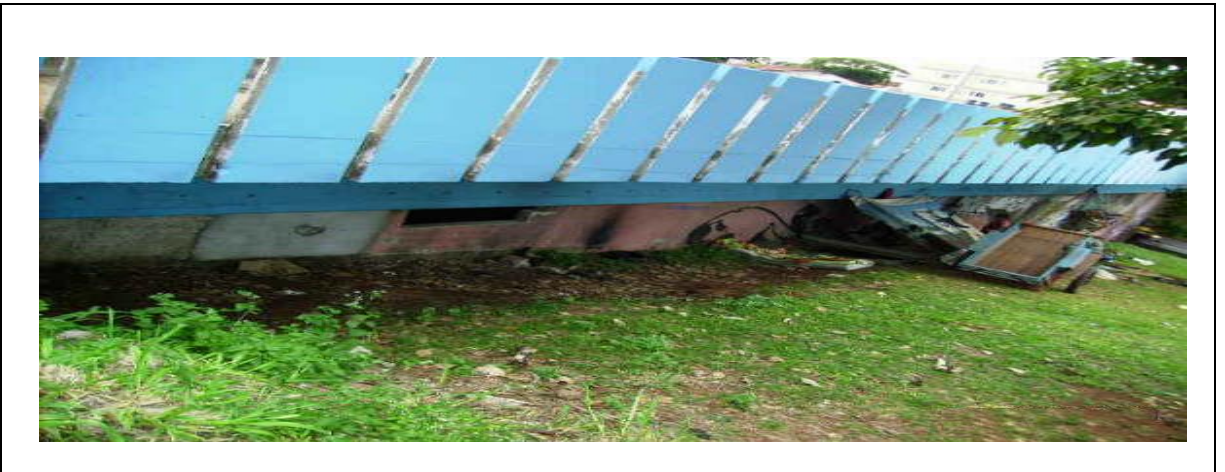
Figura 16: Viaduto da marginal botafogo no setor sul. Localizado na da ponte do Cepal do Setor Sul que liga ao Setor Universitário. O local está sendo utilizado como abrigo por moradores de ruas e que tal situação está trazendo desconforto e sensação de insegurança.
