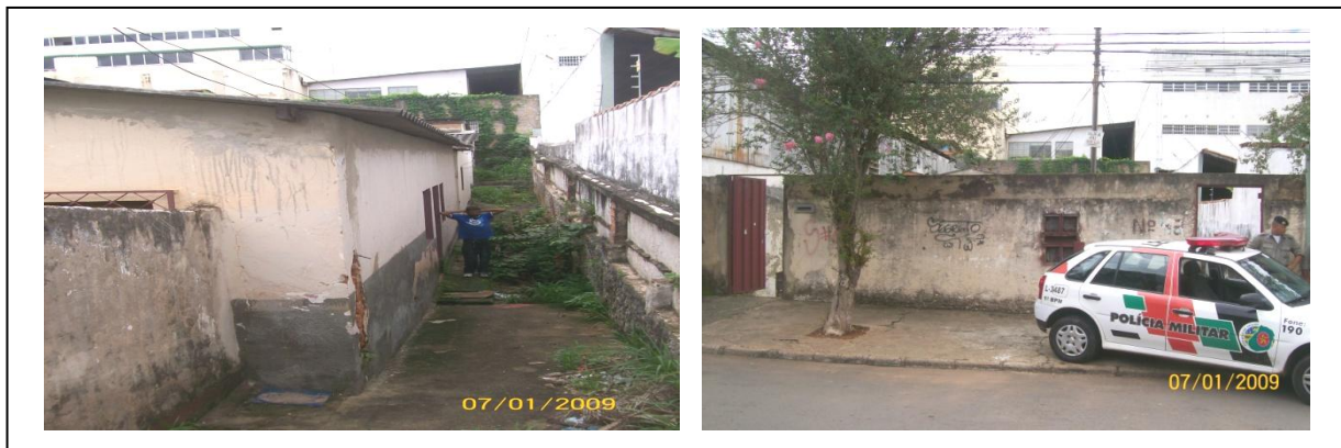
Figura 05: Casa abandonada. Rua 15 A Qd. 70 Lt. 35 N° 42, Setor Aeroporto. Casa abandonada que serve de abrigo para usuários de drogas e moradores de rua. Os vizinhos relatam que é frequente a presença de estranhos no local, possíveis infratores da lei que utilizaram o local para esconder objetos furtados.
